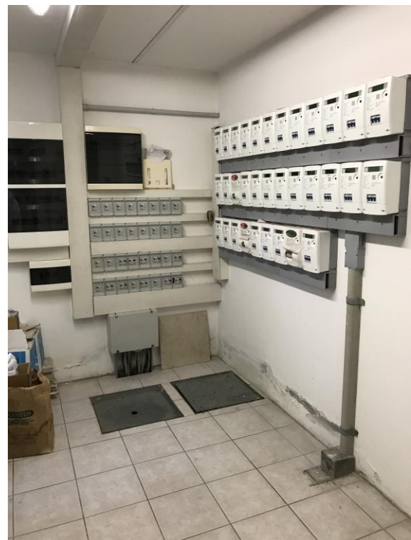
Fig.29: quadri elettrici e contatori enel piano seminterrato
