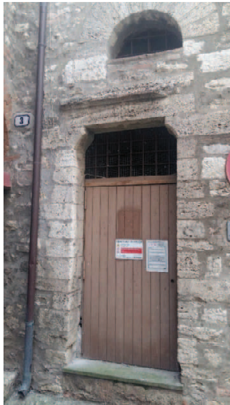
FOTO 6 – INGRESSO LOCALE CENTRALE TERMICA
