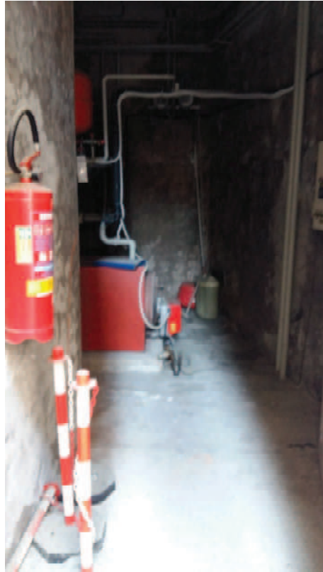
FOTO 7 – LOCALE CENTRALE TERMICA
