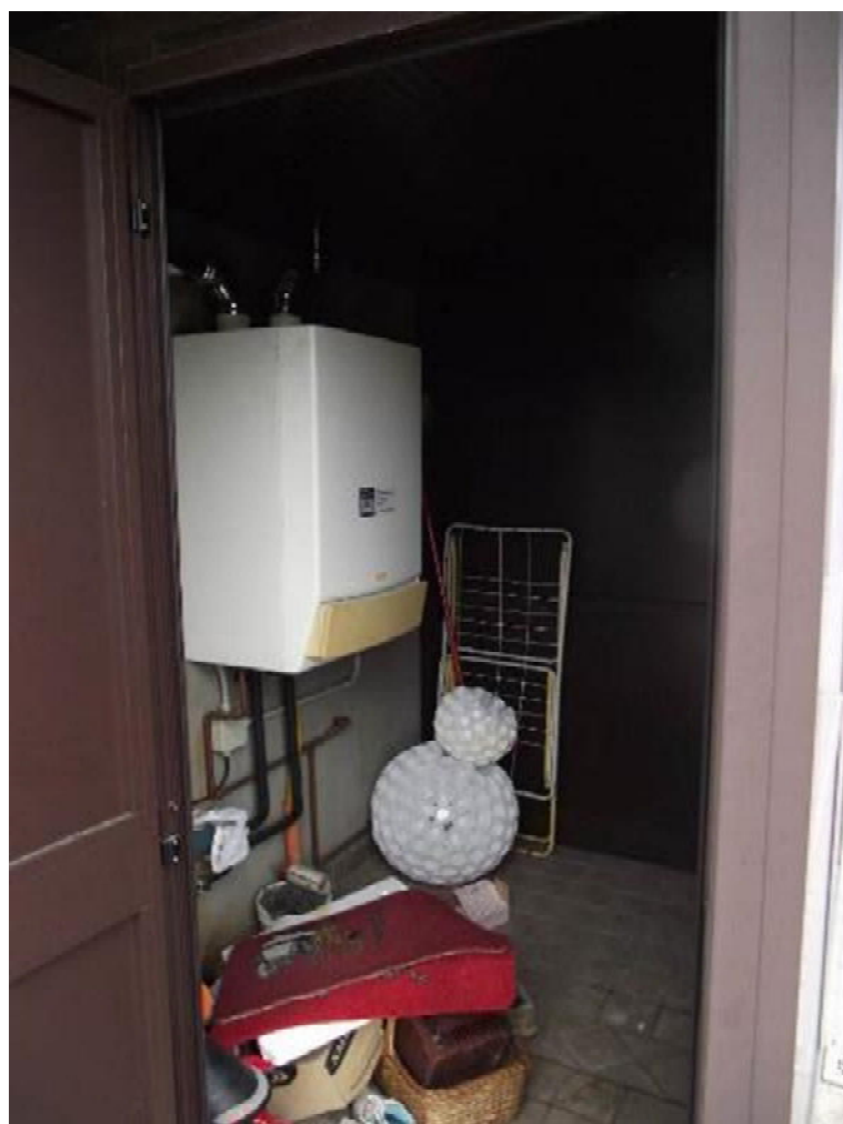
Foto 30 – caldaia murale a metano
