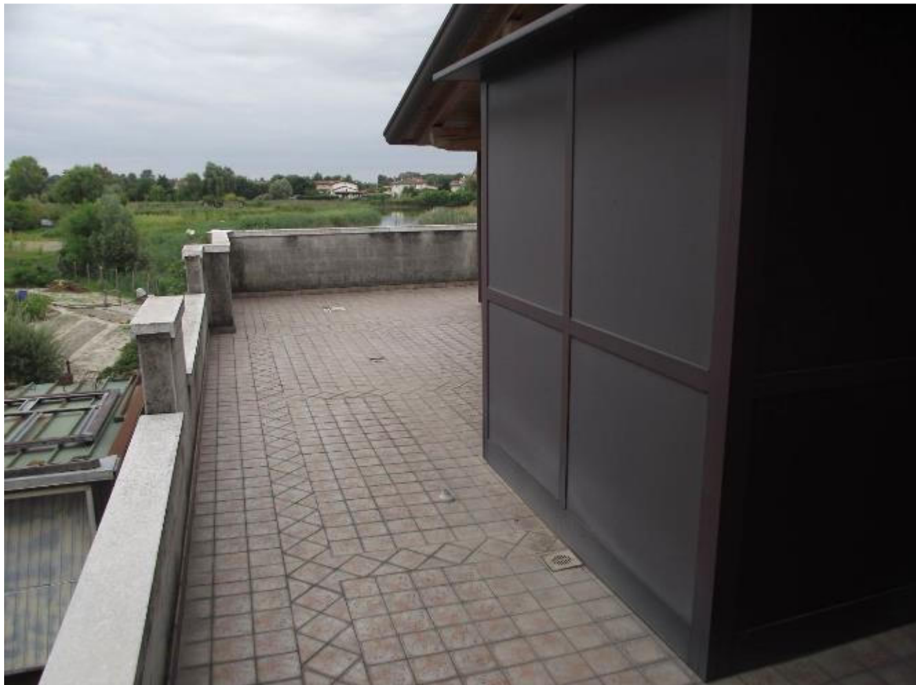
Foto 28 – terrazzo su retro, con annesso uso c.t. abusivo
