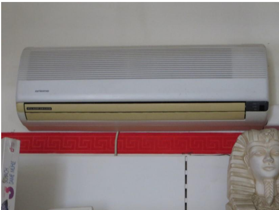
FOTO 50: UNITA' INTERNA DEL CLIMATIZZATORE
