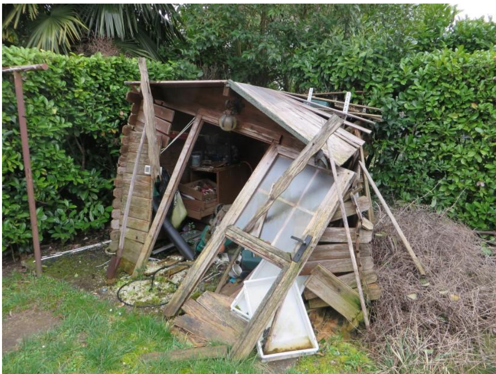
FOTO 10: FABBRICATO IN LEGNO ABUSIVO (zona Sud-Ovest)
