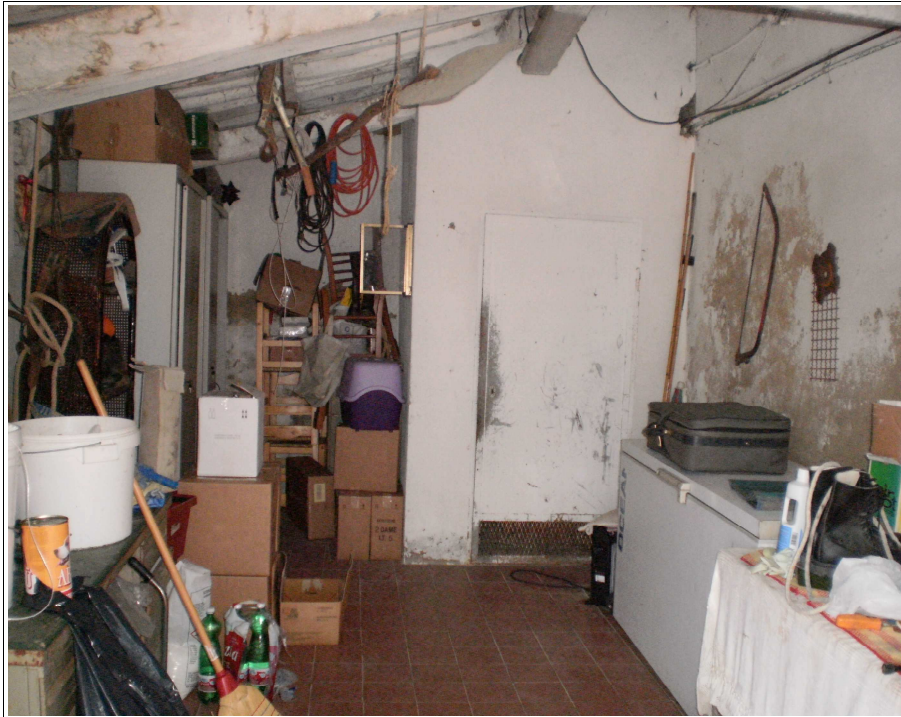
Locale centrale termica
