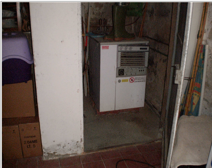
Locale centrale termica
