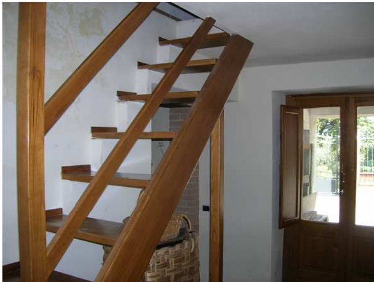
Vano Piano Terra con scala interna (senza titolo autorizzativo)
