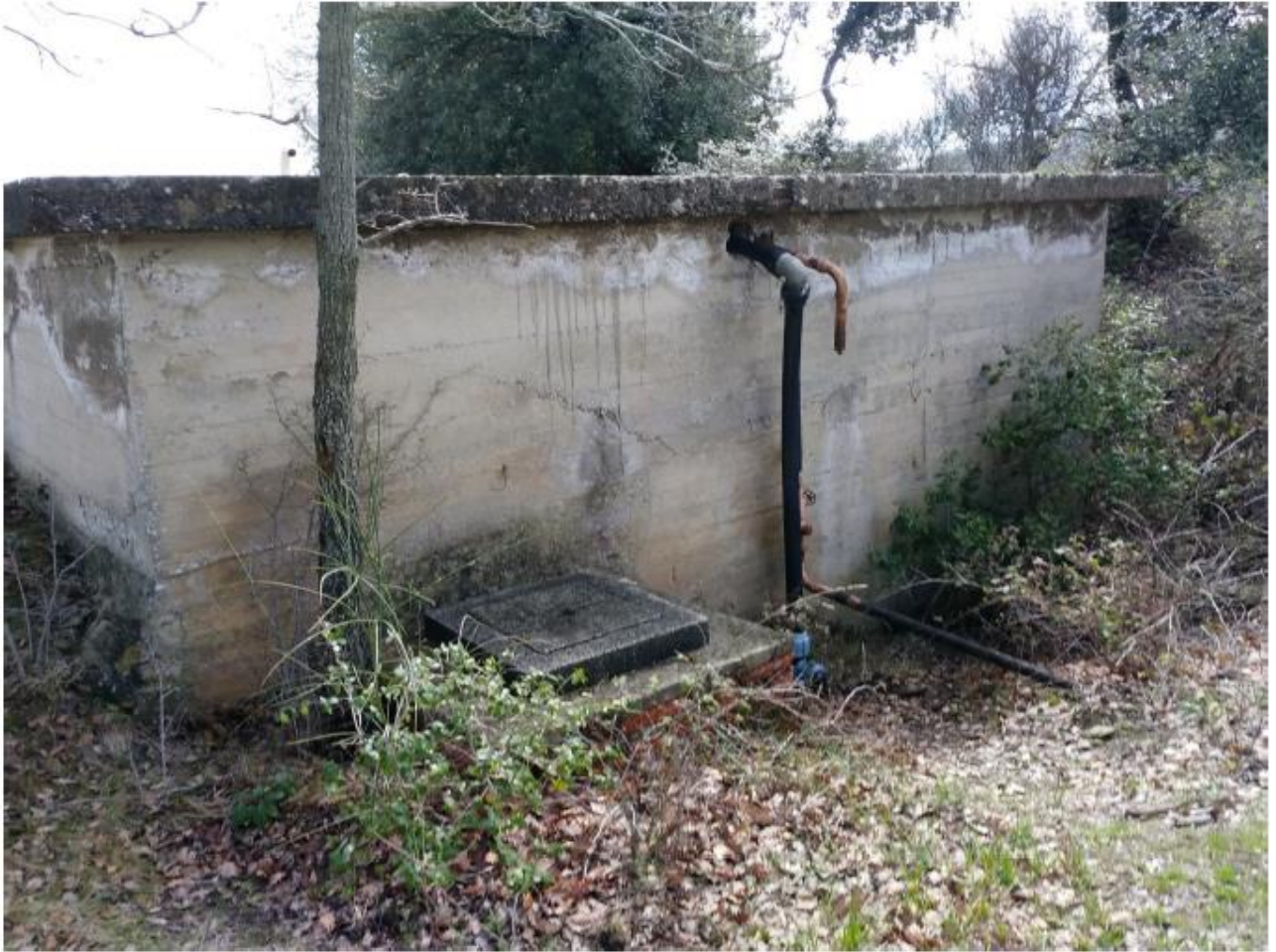
Cisterna di accumulo e distribuzione idrica Foto 3
