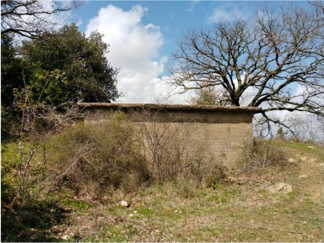
Cisterna di accumulo e distribuzione idrica Foto 1
