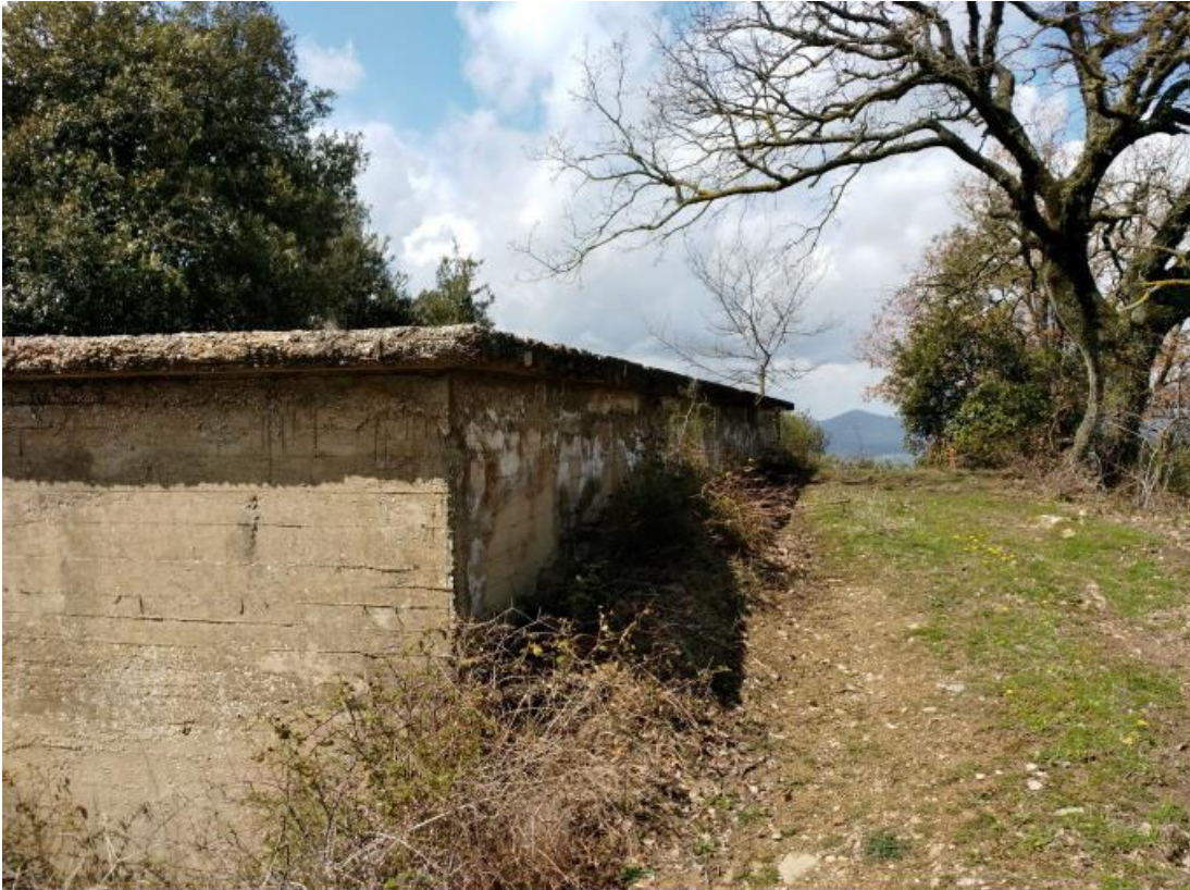
Cisterna di accumulo e distribuzione idrica Foto 2
