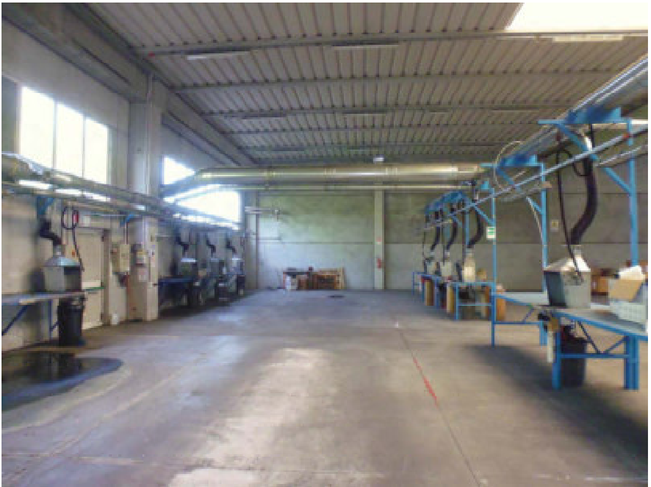
Foto 48 – particolare infiltrazioni d'acqua lato est
