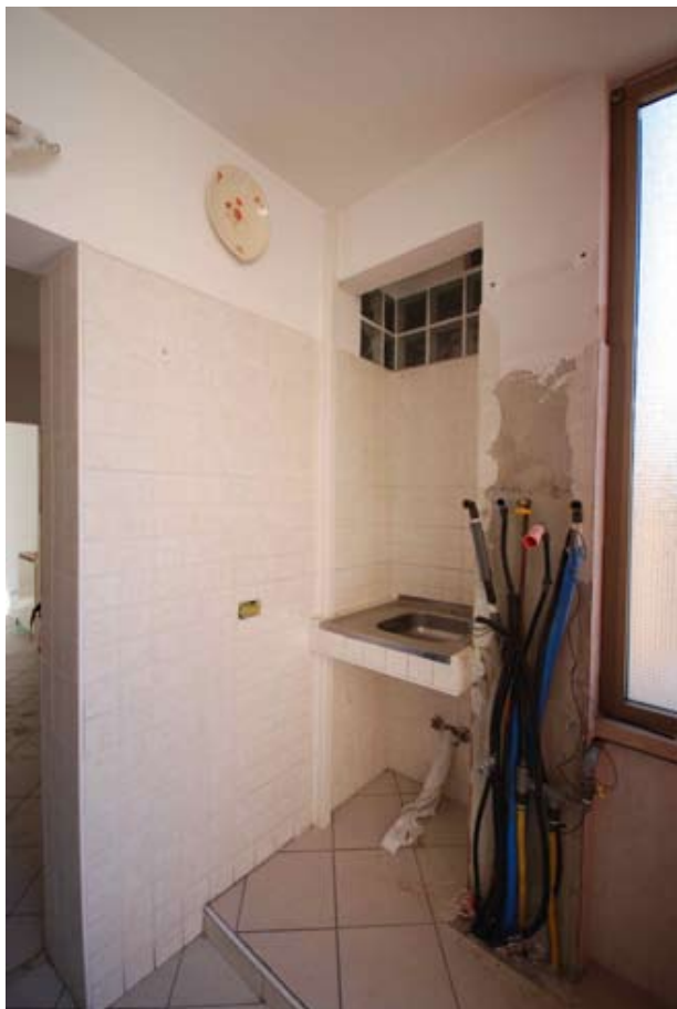
Foto 13_ Interno_Ambito veranda_attacchi caldaia
