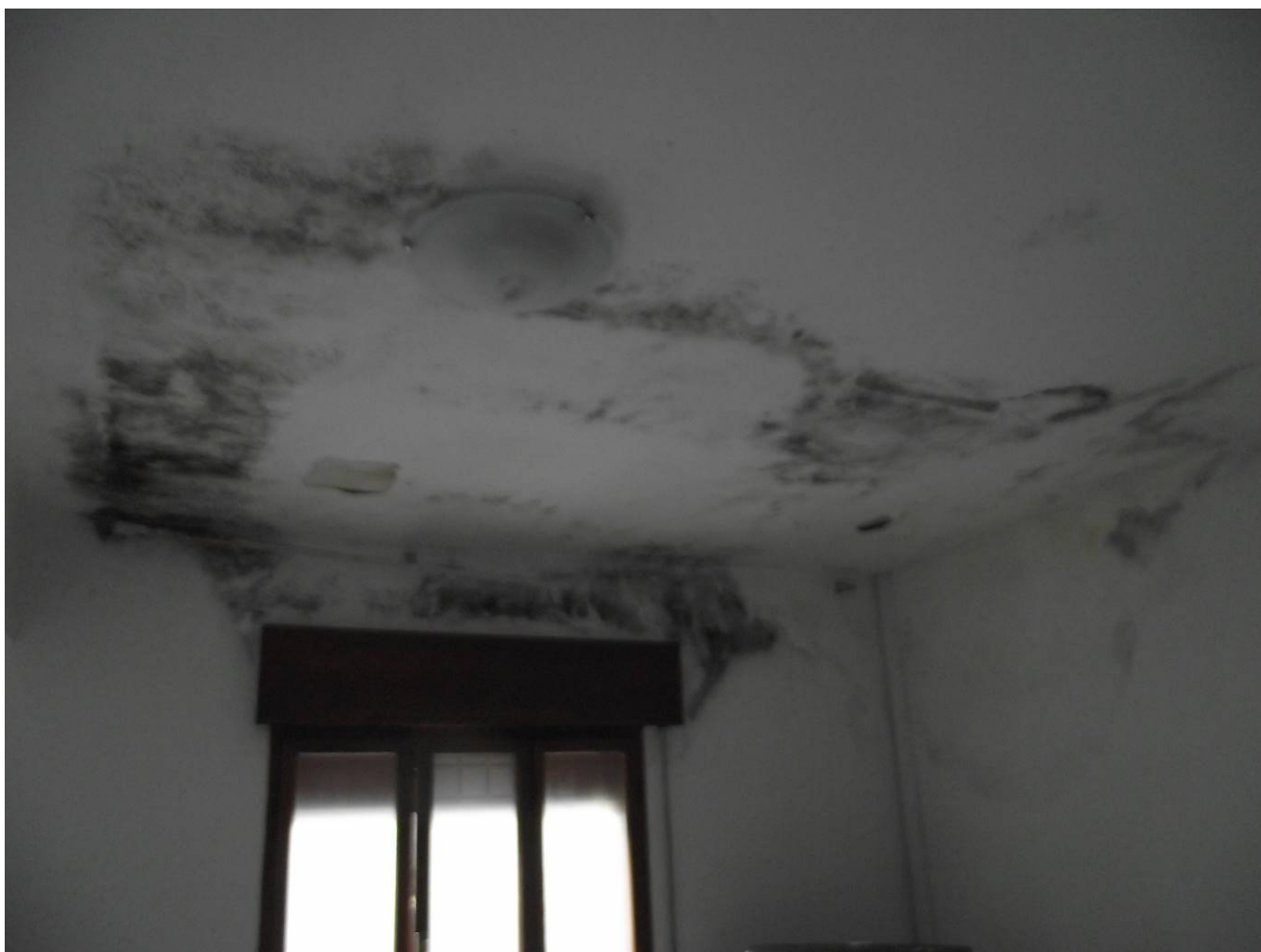
Foto 14 – infiltrazioni dalla copertura
