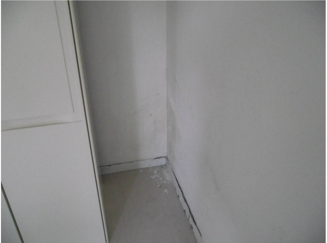
Foto 6 – umidità in camera da letto
