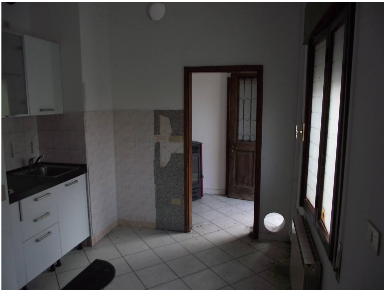
Foto 11 – cucina con infiltrazioni dalla copertura
