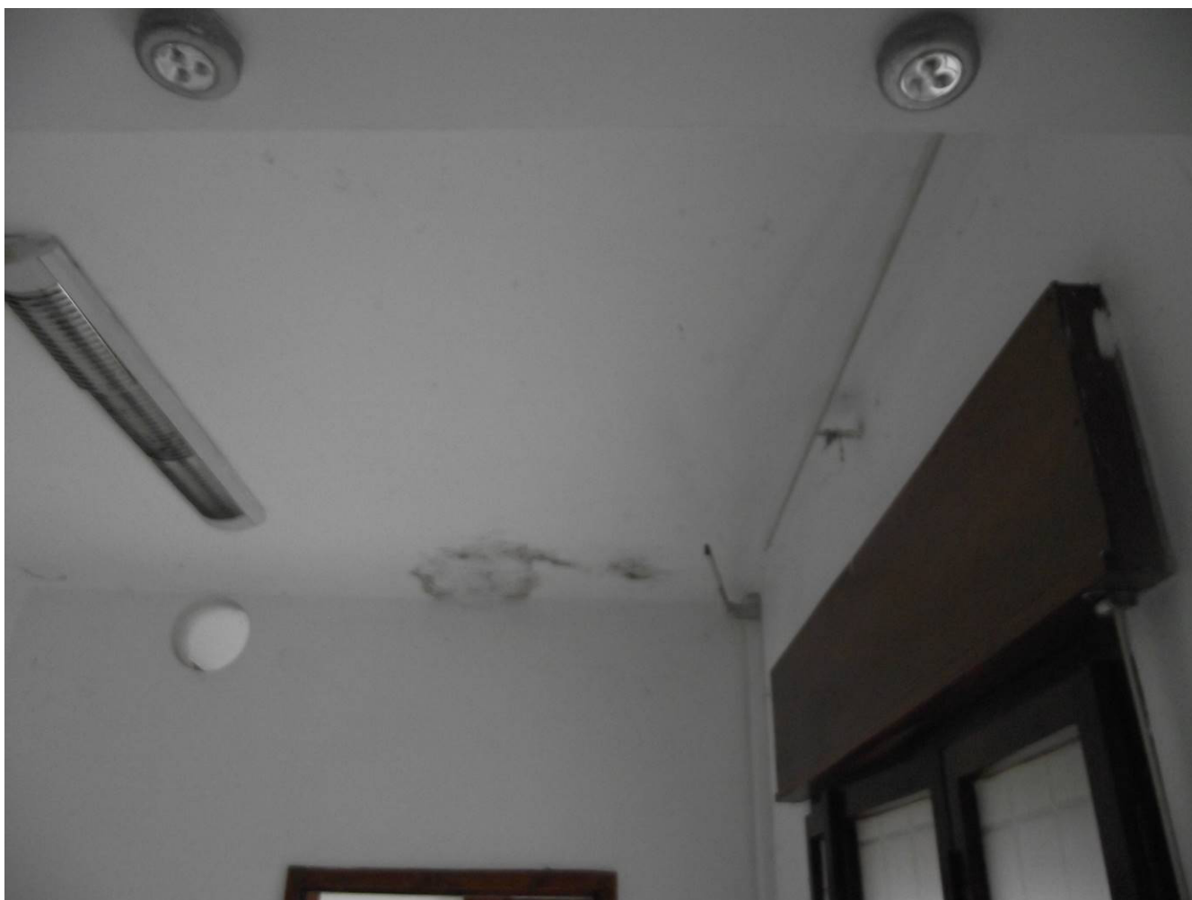
Foto 12 – infiltrazioni dalla copertura
