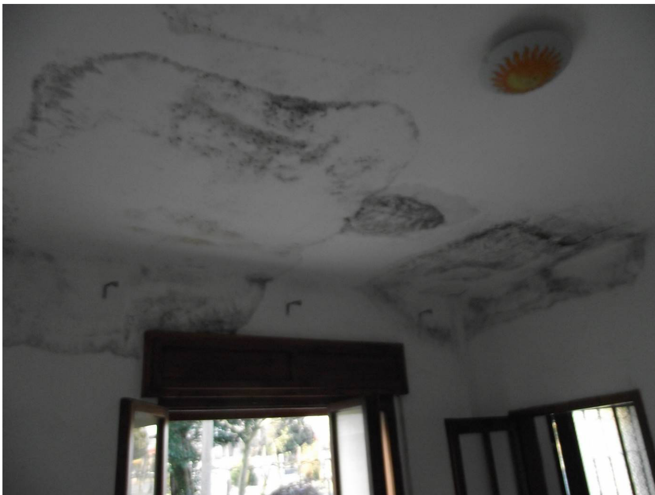
Foto 7 – infiltrazioni d'acqua dalla copertura
