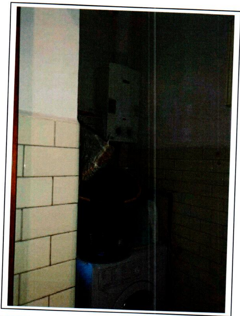
Fotografia n° 9–Vista del piccolo vano ove è installato scaldabagno e lavatrice
