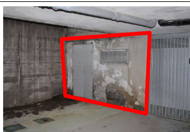
Vano tecnico P49 presso il condominio LA VETTA.
