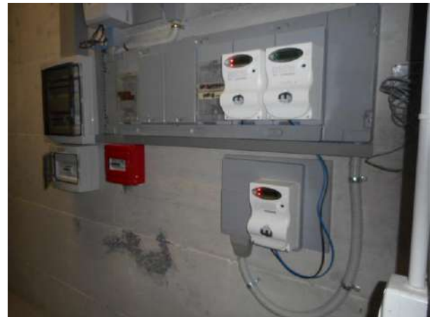
Contatori enel nel sottoscala sub. 10, bcnc a tutti i subalterni.
