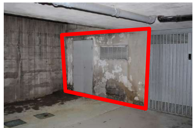
Vano tecnico P49 presso il condominio LA VETTA.
