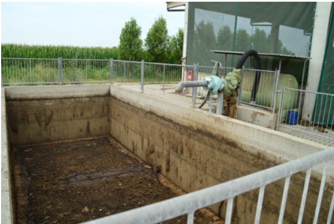
Foto 11,12 – vasche di decantazione
