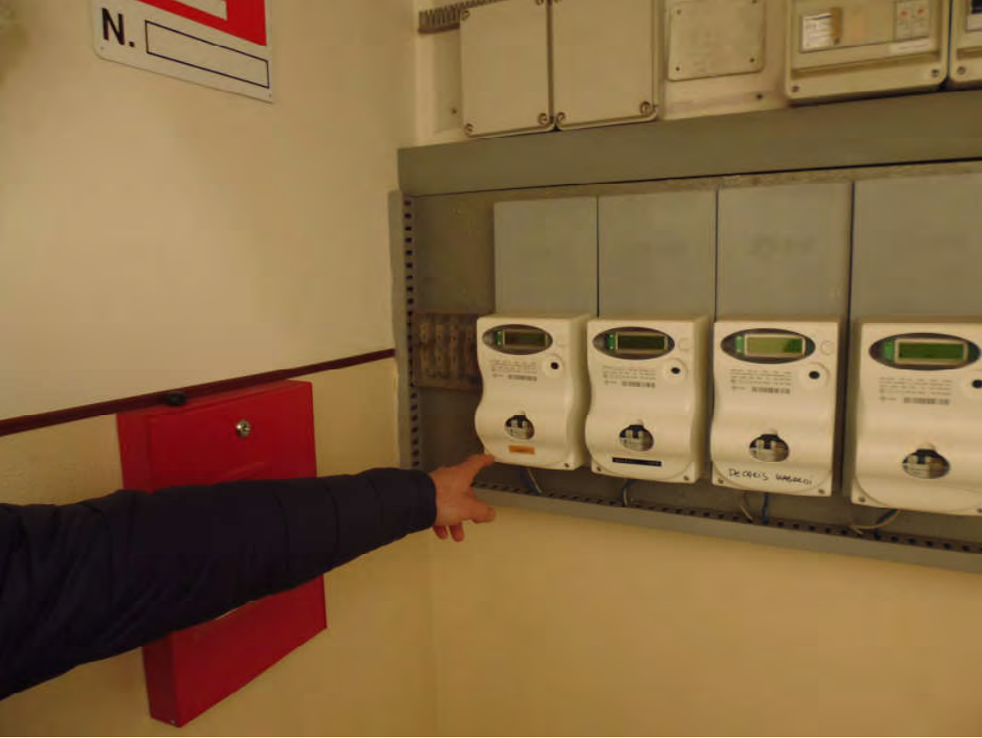
Contatori energia elettrica
