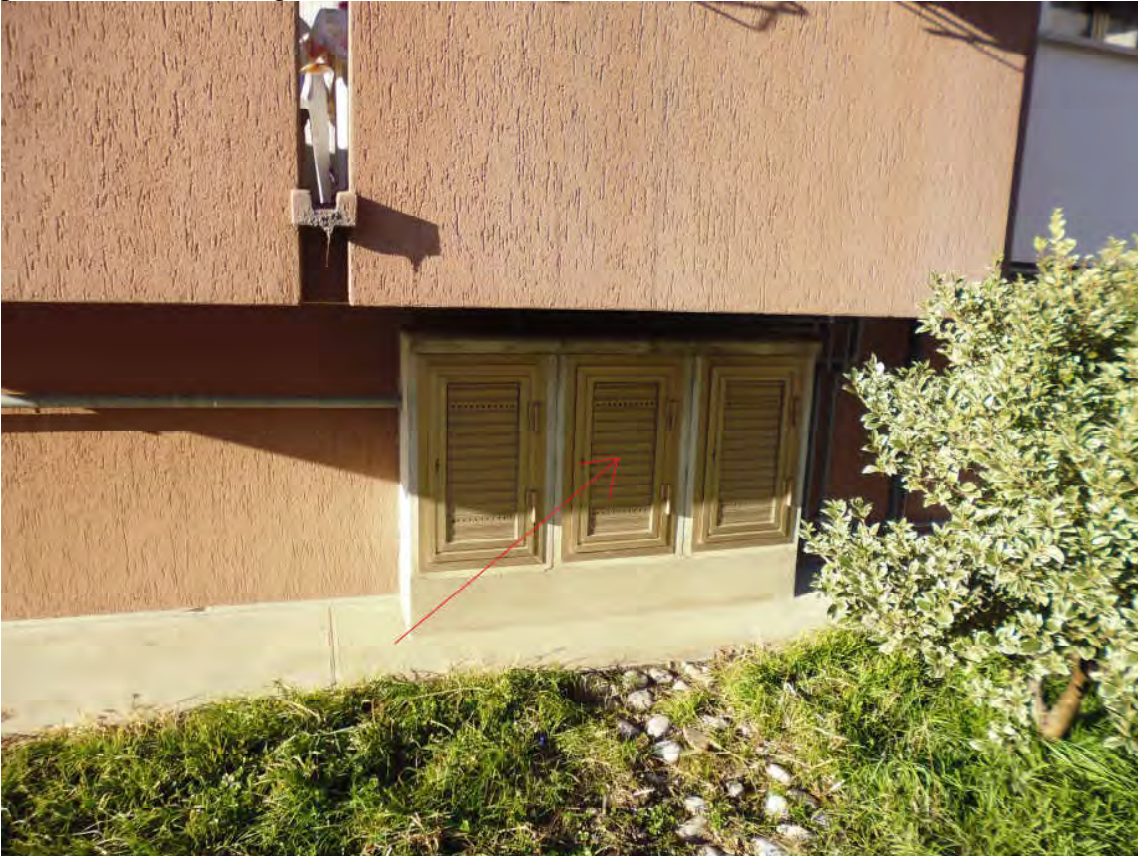
particolare contatore gas metano dell'unità
