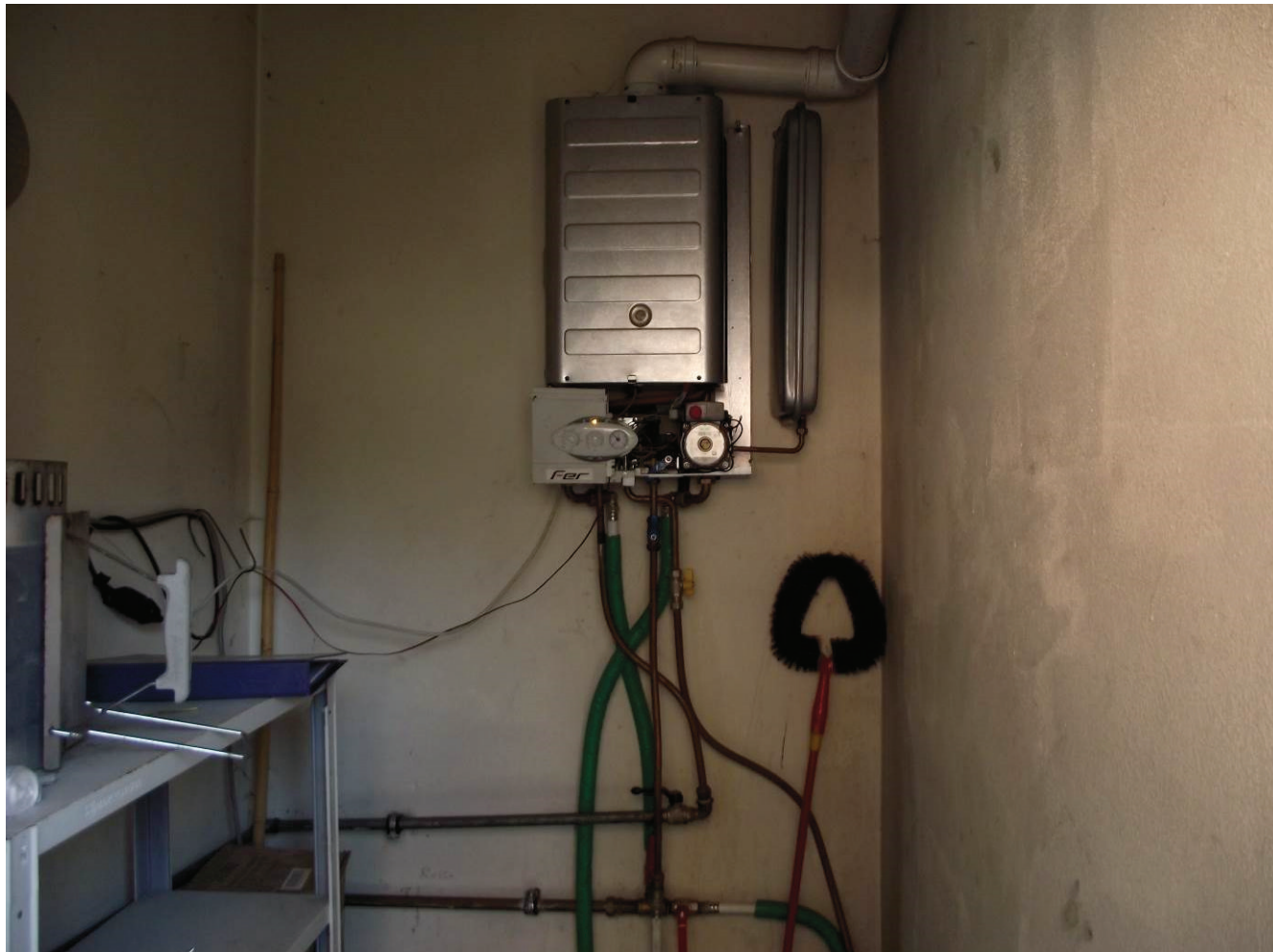
Foto 16 – centrale termica esterna
