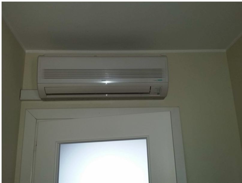
Unità interna presente nel corridoio della zona notte
