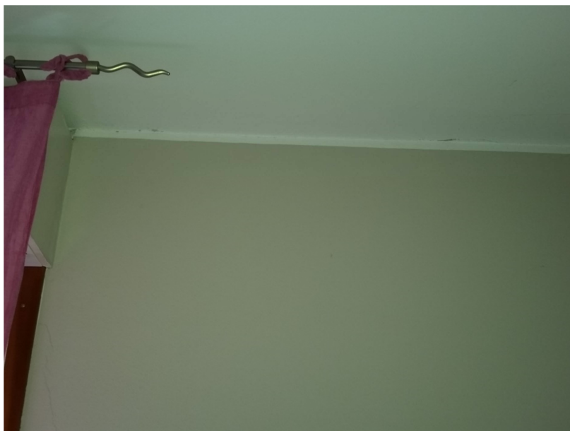
Cavillature presenti nel punto di contatto tra il solaio e le pareti perimetrali
