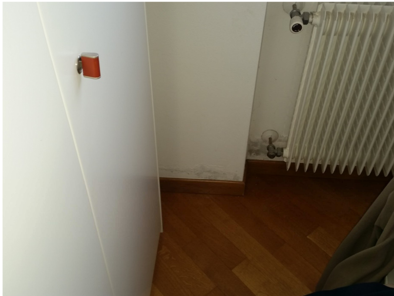
Vista interna ulteriore vano (adiacente alla camera matrimoniale) e particolare degrado pareti
