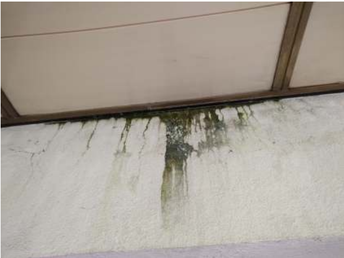
Foto n. 32 – Infiltrazione d'acqua dal soffitto della veranda.
