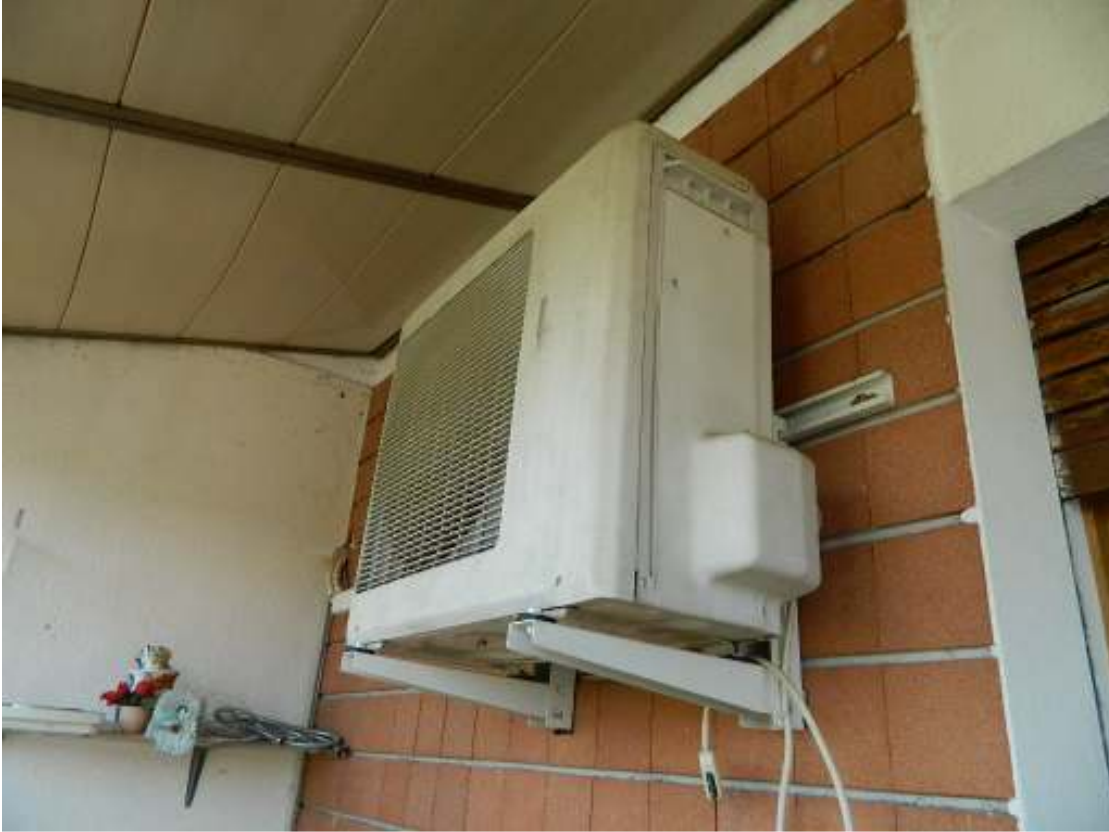
Foto n. 25 – Unità esterna impianto di climatizzazione.
