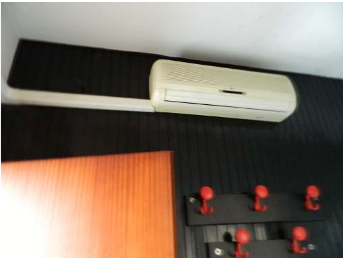
Foto n. 26 – Unità interna impianto di climatizzazione.
