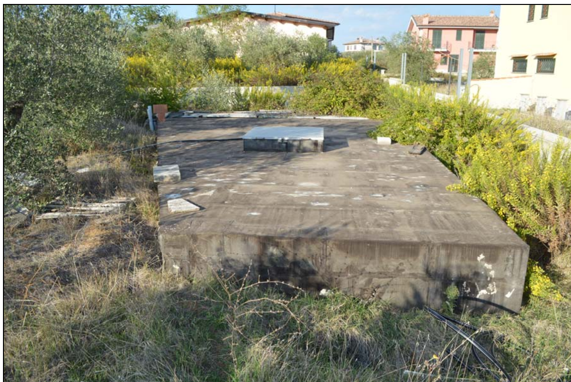
Foto n. 34 - Cisterna per irrigazione aree verdi pertinenziali
