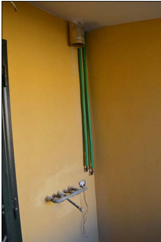
Foto n. 103 – Particolare attacco caldaia Loggia (P.T.)
