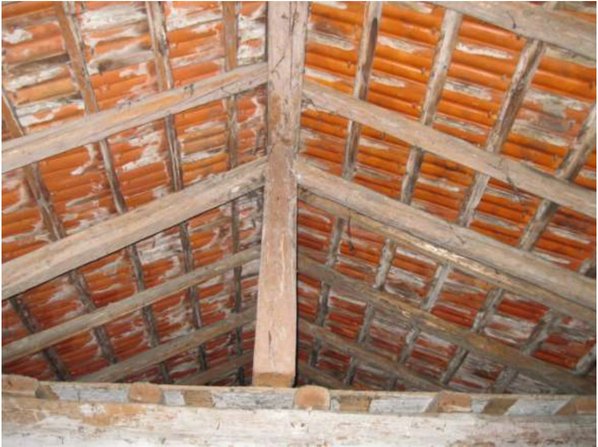
Foto 22 Copertura di tegole senza isolamento
