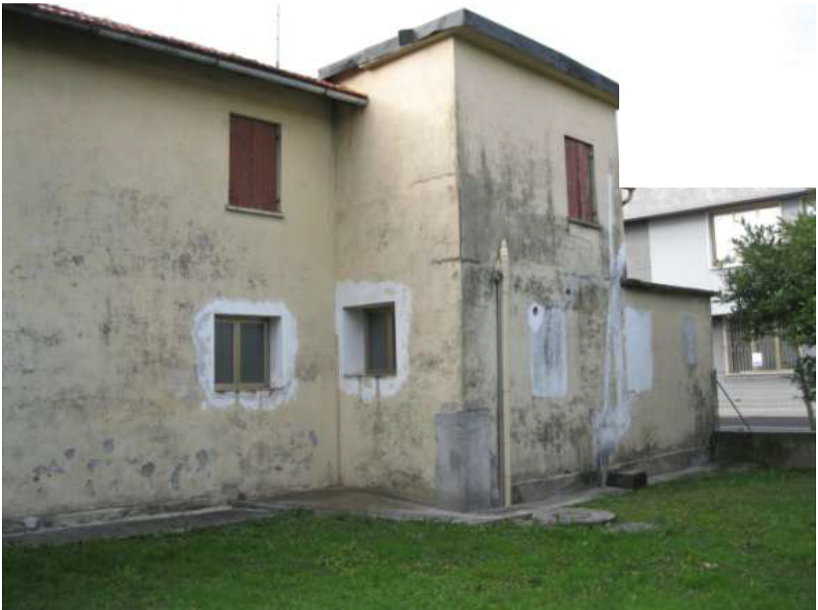
Foto 23 Particolare intonaco esterno
