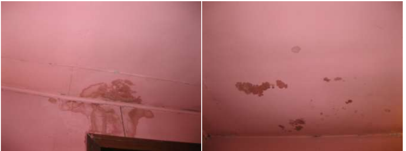
Foto 21 Infiltrazioni al primo piano
