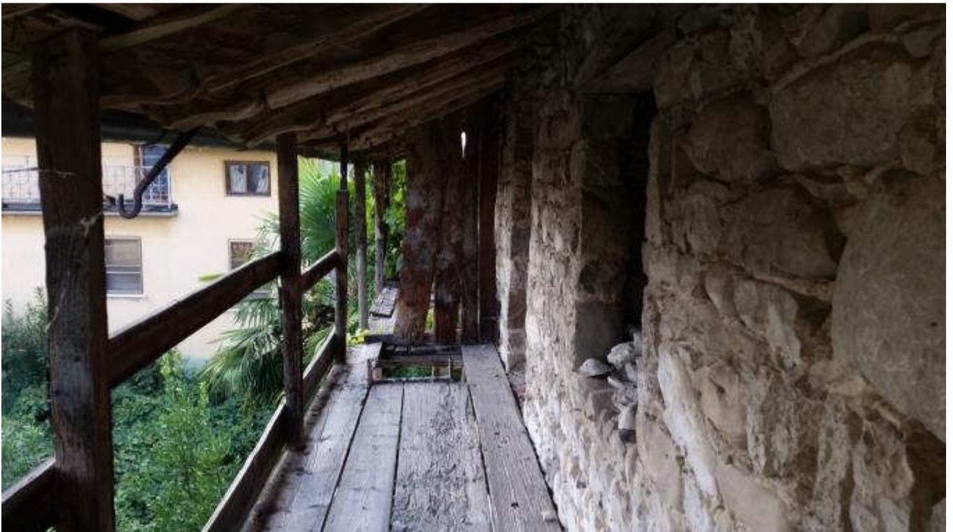
Foto 18: Terrazzo al 2°P. antistante la soffitta con accesso tramite scala d'appoggio nella botola di pavimento (Mapp.714).
