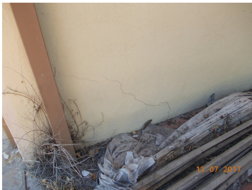
Foto 39 Lesioni su spigolo sud-est
