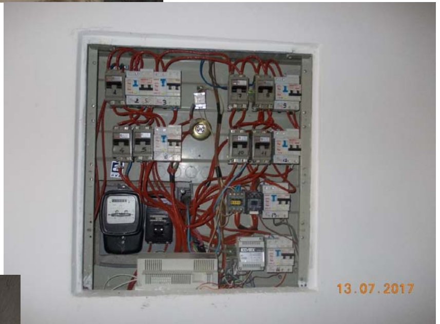
Foto 32 Quadro elettrico generale
