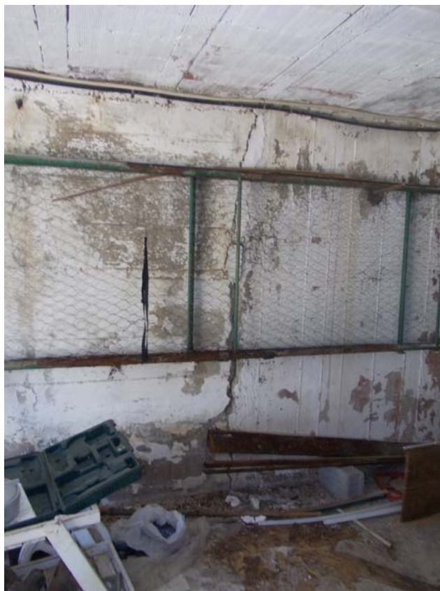
Foto 34-35 Garage - Lesioni su pareti laterali
