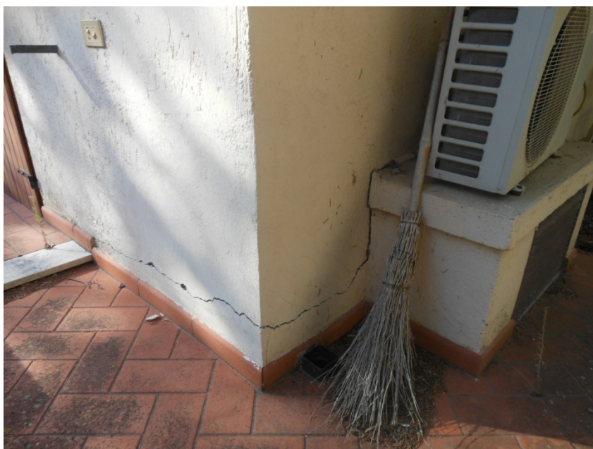
Foto 36 Lesioni su spigolo nord-est
