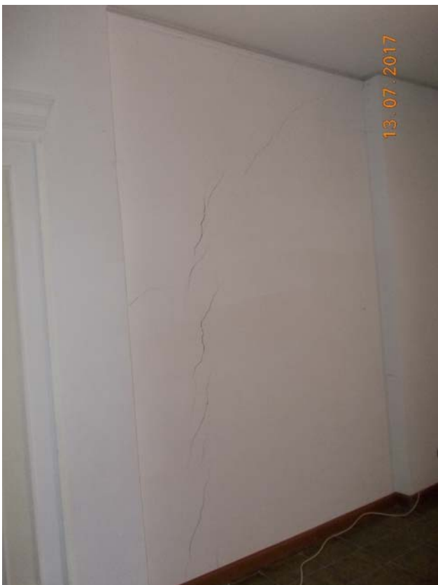
Foto 42 Soggiorno Lesioni su parete esterna est
