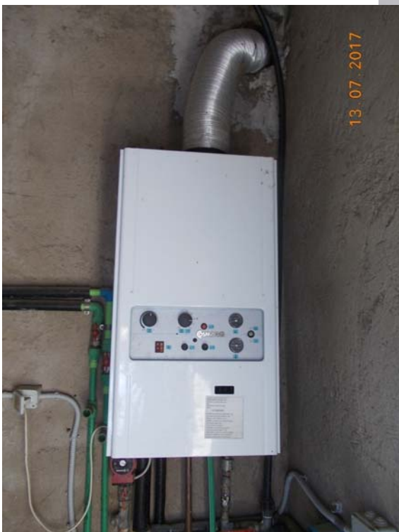
Foto 33 Caldaia in locale tecnico
