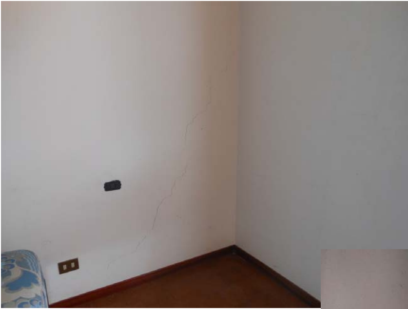
Foto 40 Camera 4 Lesioni su parete esterna est
