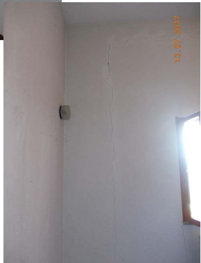
Foto 41 Camera 6 Lesioni su parete sud
