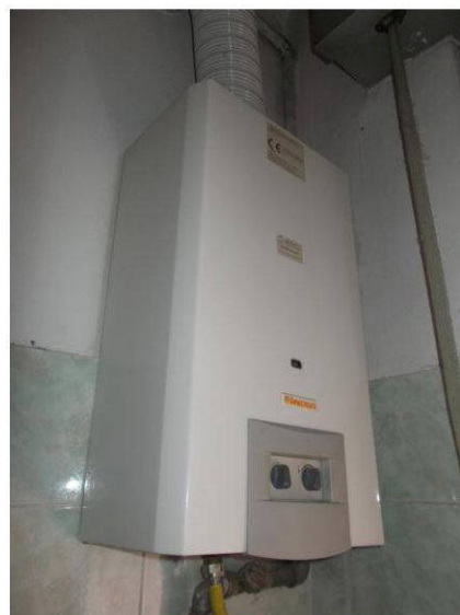
14. Caldaia nel bagno
