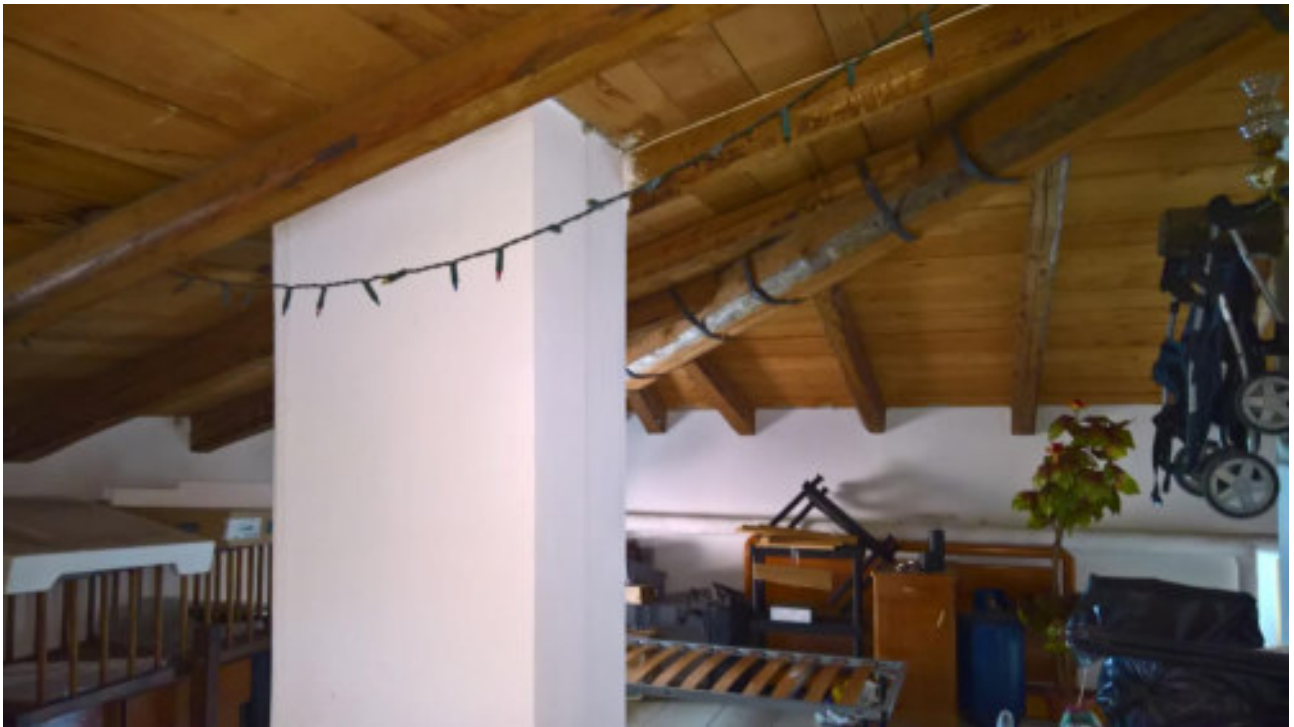
Foto n. 17 – Comune di Vivaro (PN), Foglio 19, particella n°93 sub 16 – Veduta generale della soffitta posta al secondo piano dell'abitazione.
