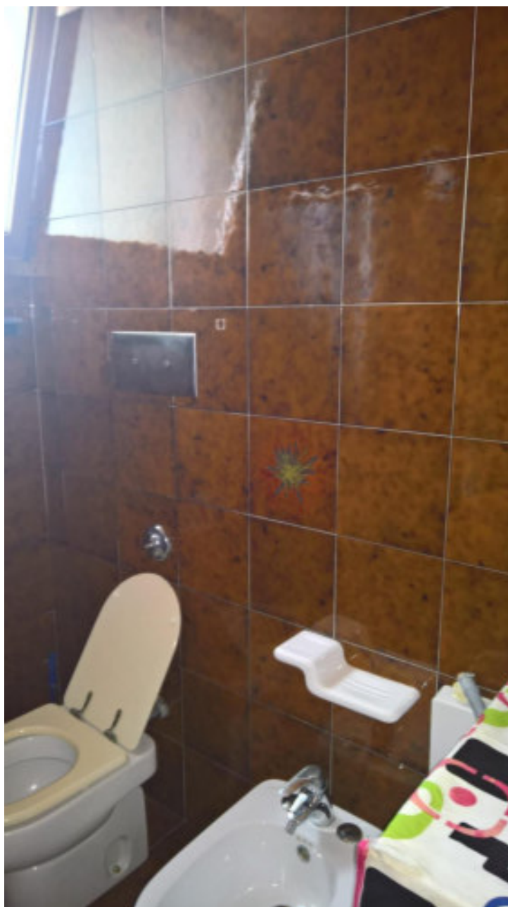
Foto n. 13 – Comune di Vivaro (PN), Foglio 19, particella n°93 sub 16 – Particolare dei sanitari all'interno del bagno.
