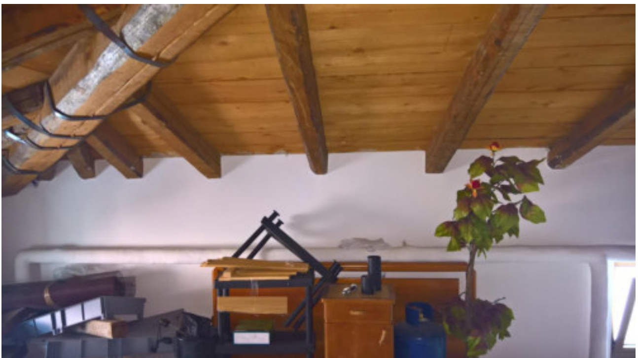
Foto n. 18 – Comune di Vivaro (PN), Foglio 19, particella n°93 sub 16 – Particolate delle travi in legno e tubature interne poste nella soffitta, al secondo piano dell'abitazione.
