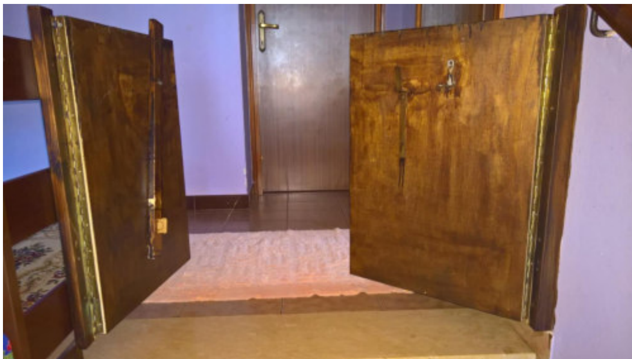
Foto n. 6 - Comune di Vivaro (PN), Foglio 19, particella n°93 sub 16 - Particolare del cancelletto di sicurezza scale posto al primo piano.
