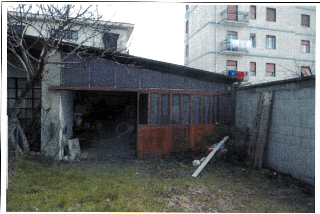
Fotografia n°10 – Vista del giardino comune particella 519 – sul fondo si osserva la tettoia chiusa non censita.
