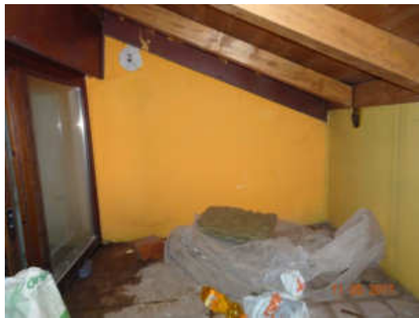
particolare ripostiglio con infiltrazione acqua dal tetto
