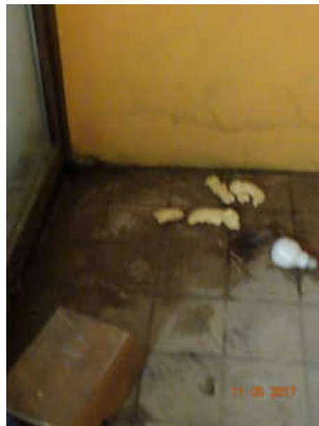
ulteriore particolare ripostiglio con infiltrazione acqua dal tetto
