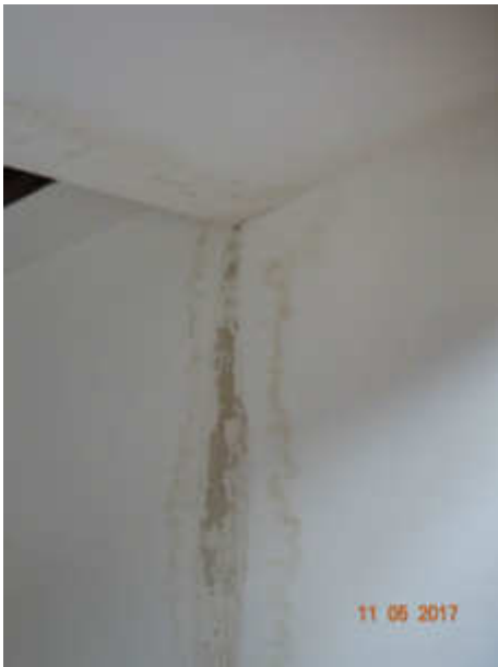
particolare ripostiglio con infiltrazione acqua dal tetto
