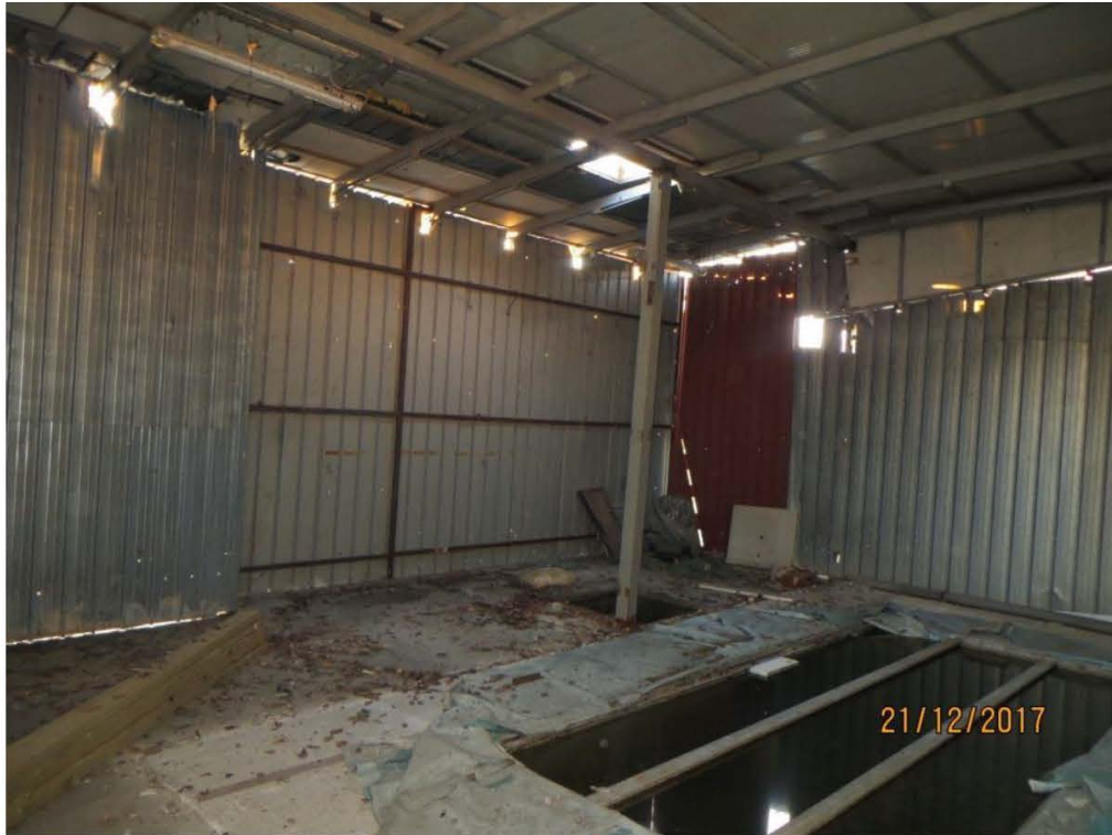
Foto 13 – Costruzione metallica ad uso autofficina meccanica (da rimuovere ai fini della trasformazione del terreno in comparto edilizio)
