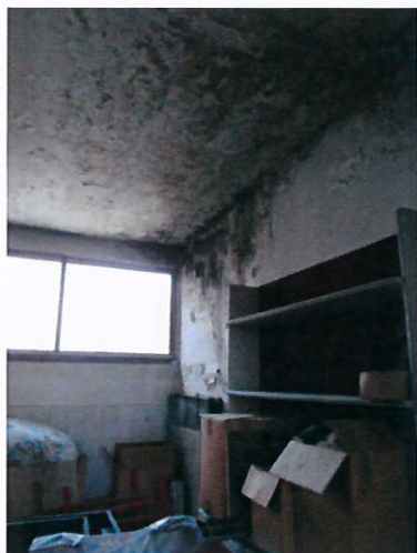
13. Deposito (con segni di infiltrazioni)
