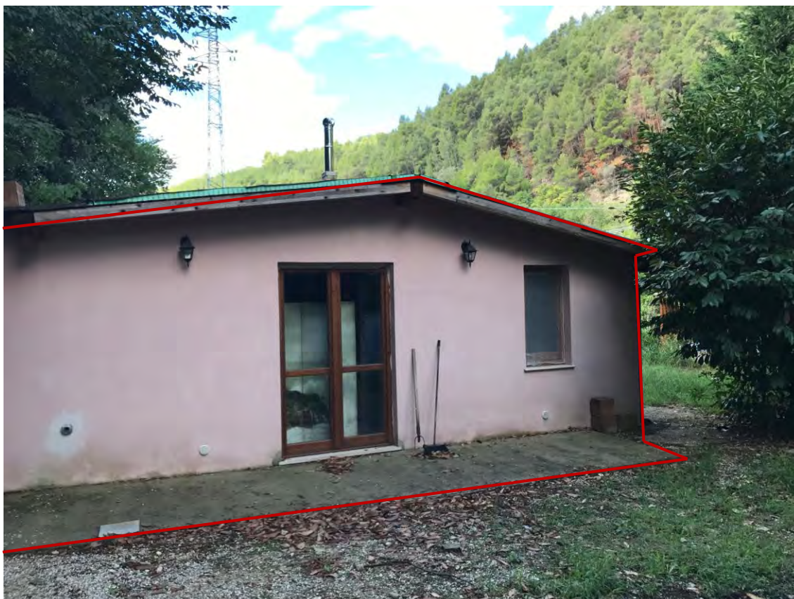
Foto n. 5: ampliamento dell'abitazione (evidenziato in rosso) realizzato abusivamente e che deve essere demolito.
