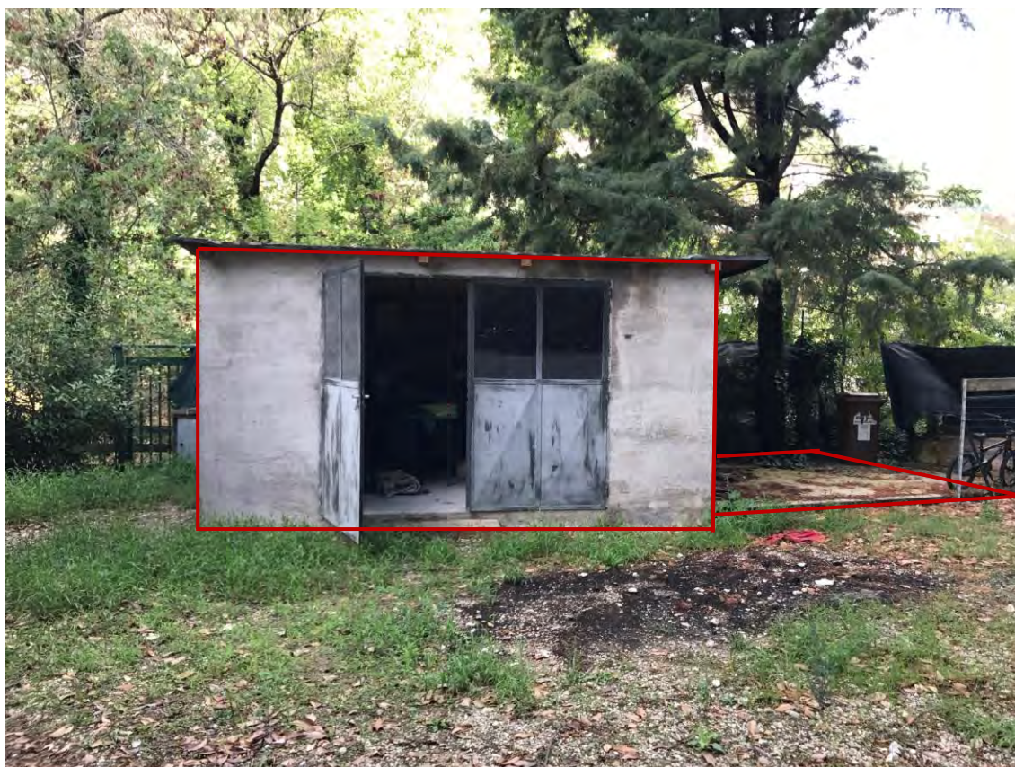
Foto n. 7: magazzino (evidenziato in rosso) realizzato abusivamente e che deve essere demolito.
