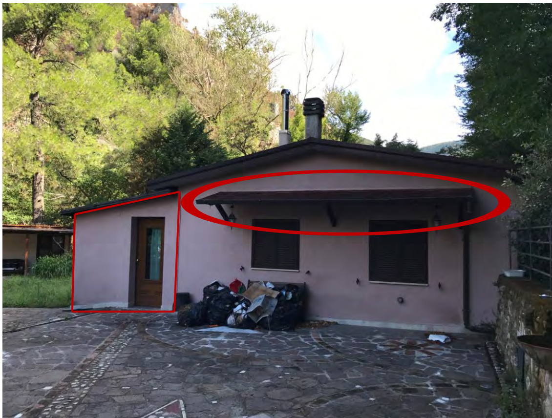
Foto n. 3: abitazione e corte esterna viste dal secondo cancello di accesso. La porzione evidenziata in rosso, così come la tettoia, è una delle opera abusive realizzate e che devono essere demolite.
