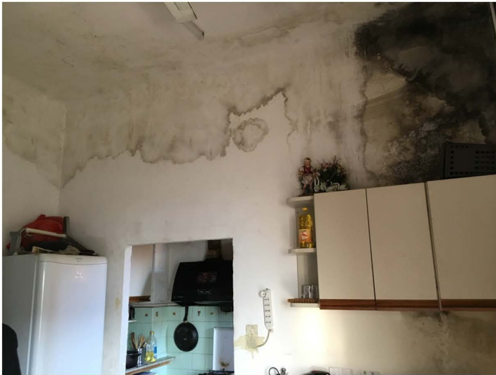
Soggiorno - muffe sul soffitto - Via Bernardo Zamagna n°4 - Milano
