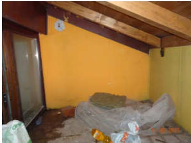
particolare ripostiglio con infiltrazione acqua dal tetto
