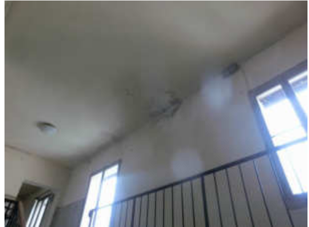
particolare infiltrazione d'acqua dal tetto nella zona vano scala
