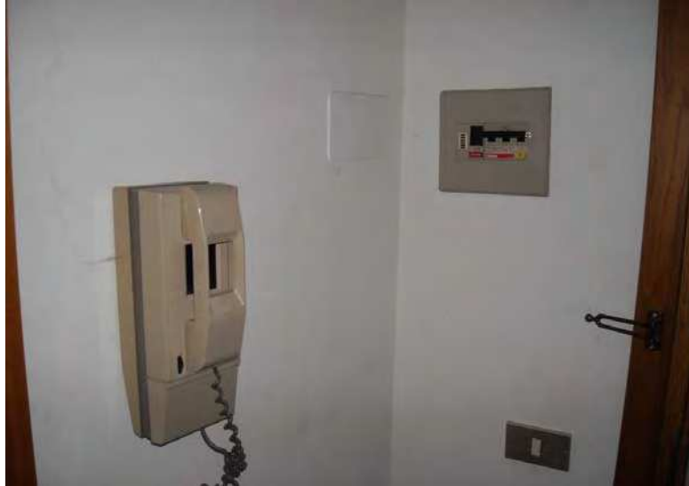
Foto 16 – quadro elettrico interno all'appartamento e citofono
