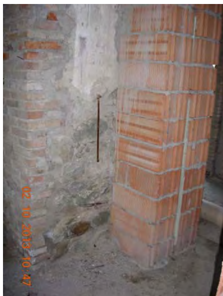
- setto di nuova costruzione non ammorsato -
