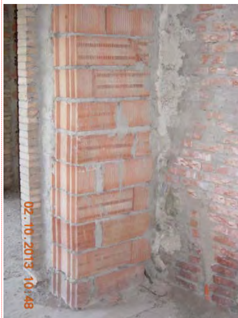
- setto di nuova costruzione non ammorsato -
