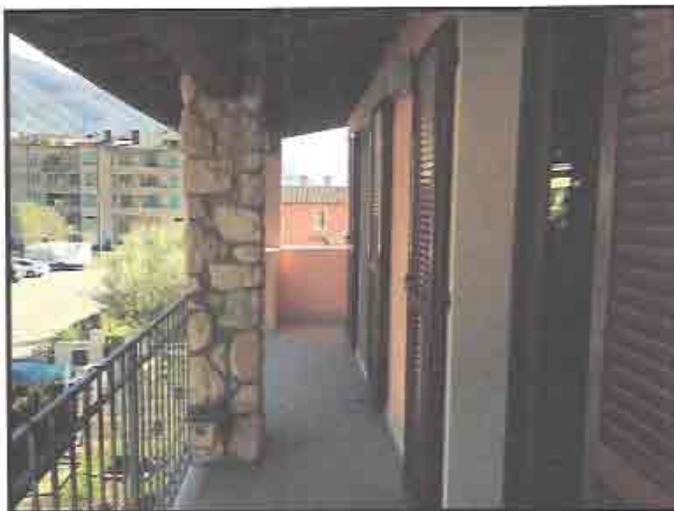
Figura 27: particolare balcone al piano primo .
