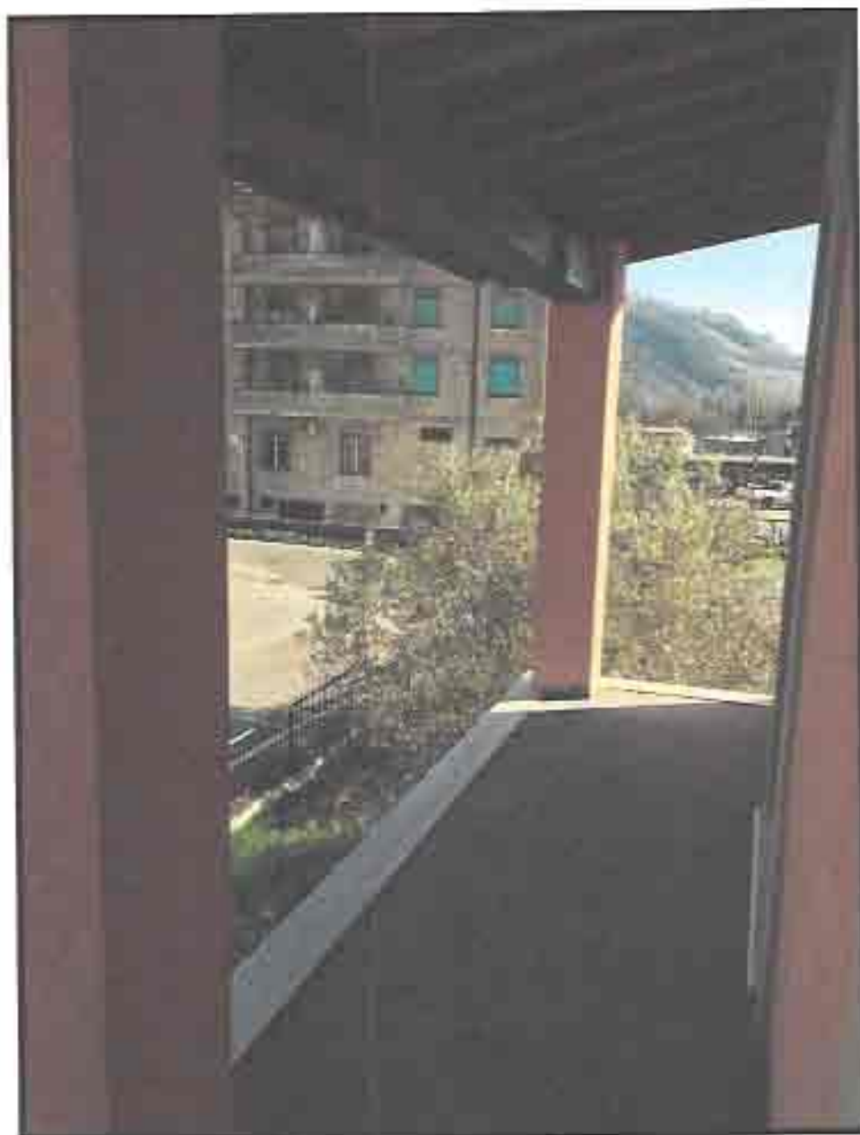
Figura 21: particolare balcone al piano primo
