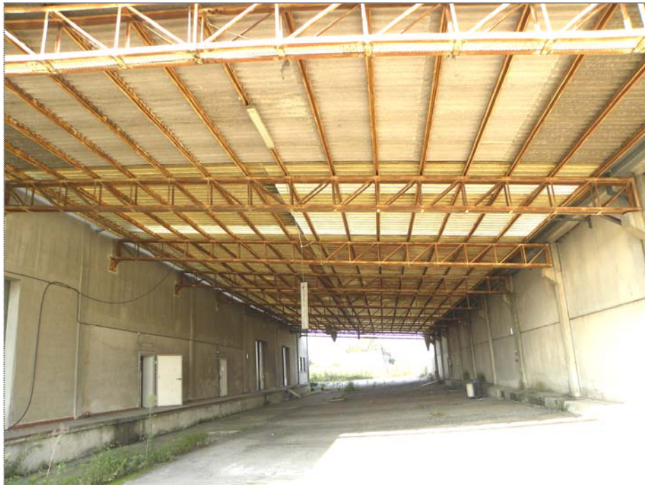
Vangadizza di Legnago (VR): tettoia delle unità sub 4 e 3 (tra corpi Sud e Nord)
