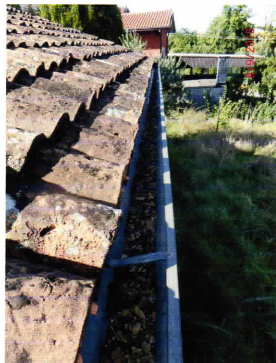
particolare sfaldamento coppi in grondaia
