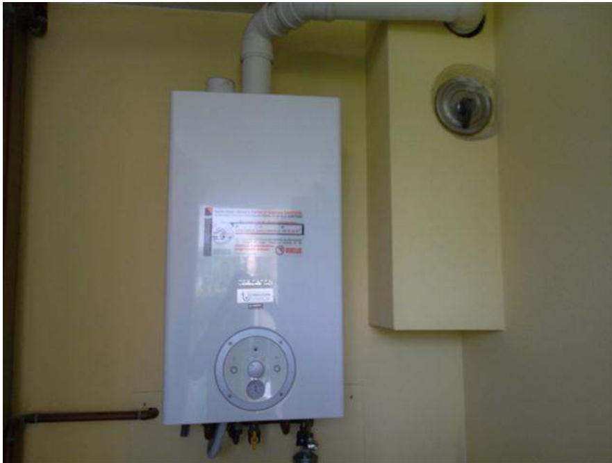
Foto n. 8: Caldaia a GAS.
