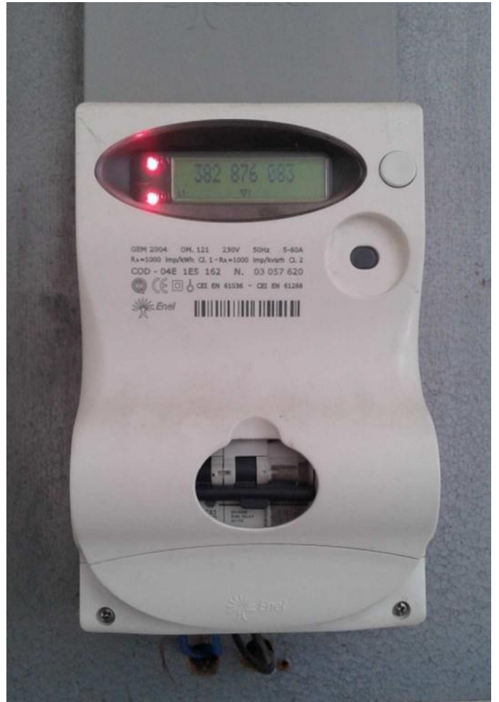
quadro elettrico di proprietà
