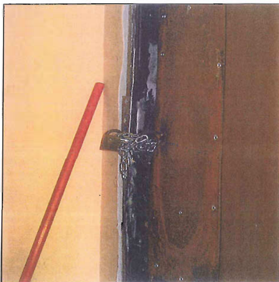
Figura 10 : Particolare del portone blindato dopo aver eseguito l'accesso forzato all'appartamento.
