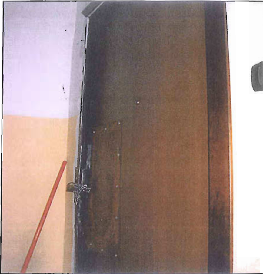
Figura 11: Particolare chiusura tramite lucchetto e catena del portone blindato d'ingresso dopo aver effettuato l'accesso forzato all'appartamento.
