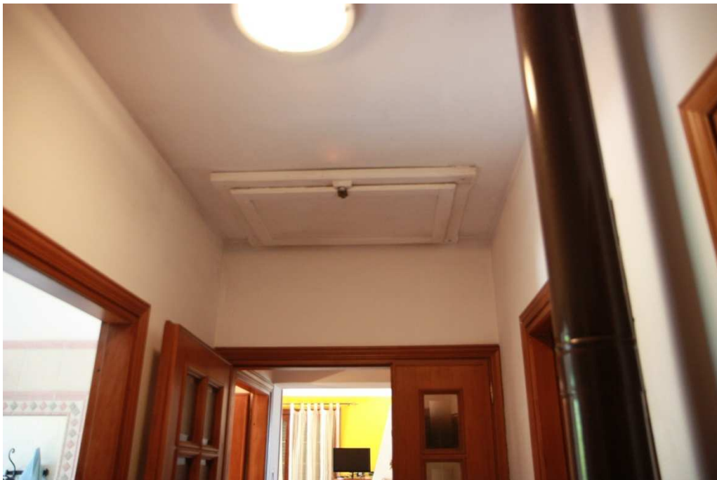
Foto n.18 Ingresso per soffitta non praticabile
