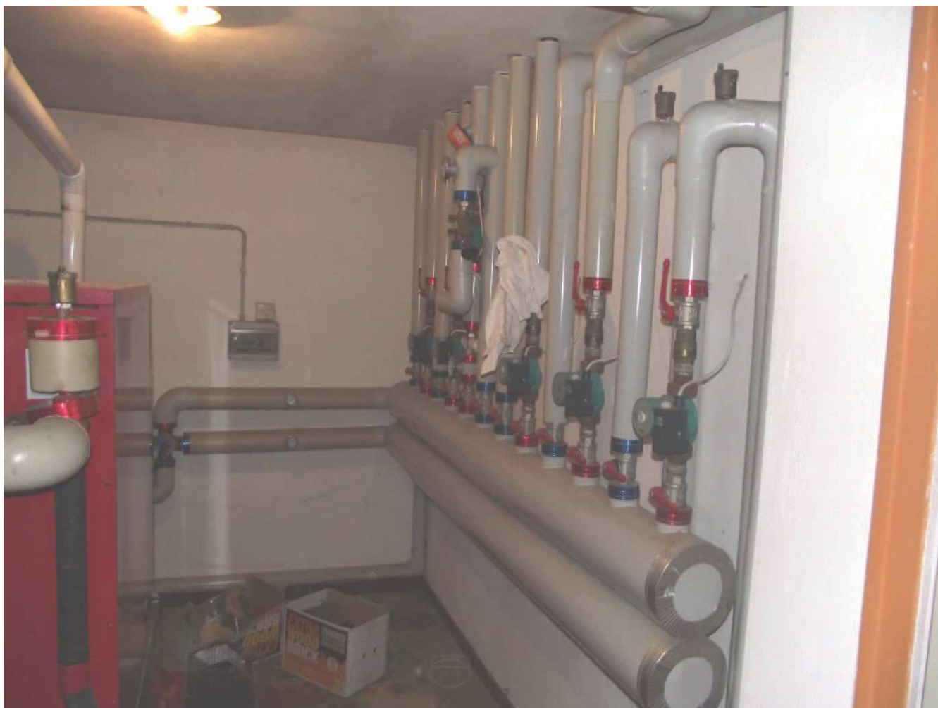
Foto 22 – piano interrato – centrale termica
