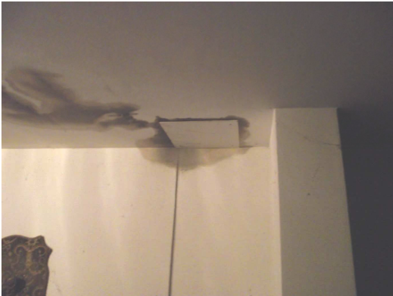
Foto 26 – piano interrato – perdita da canna fumaria
